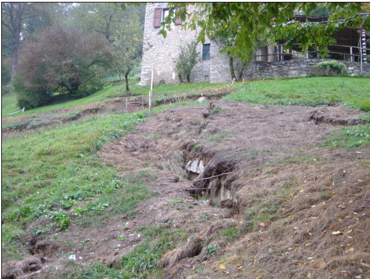
Figura 31 – Fessure di trazione della frana nell’ottobre del 2006
